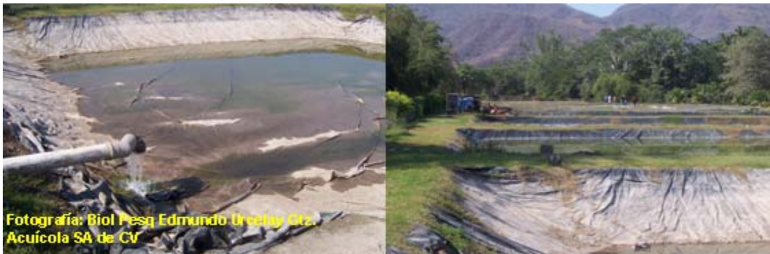
Figura 3.12 Estanques de la Ceiba de las Garzas SPR sin operar por el mal estado de los recubrimientos
