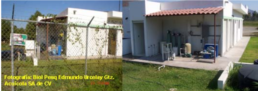
Figura 3.10 Vista exterior de la planta de procesamiento de La Ceiba de Las Garzas SPR de RL
