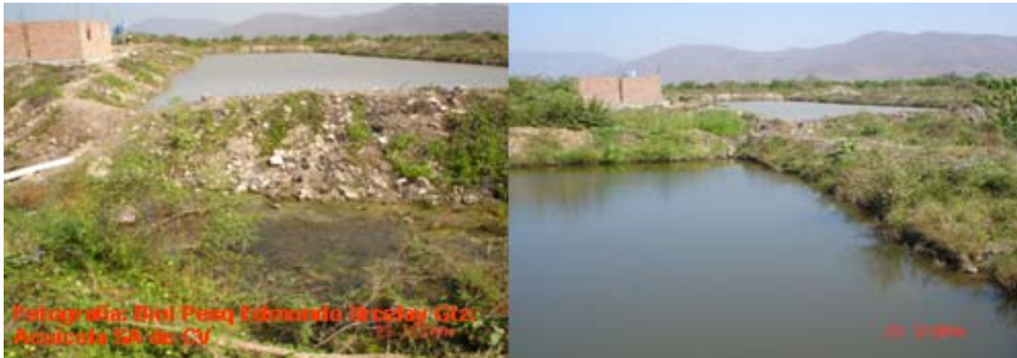
Figura 3.13 Errores de obra y drenaje es estanques de Acuícola Alejandro Tafoya Alvarado.
