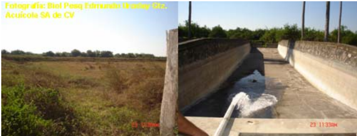
Figura 3.11 Estanques de Acuícola El Triangulo sin operar por presentar elevadas filtraciones.
